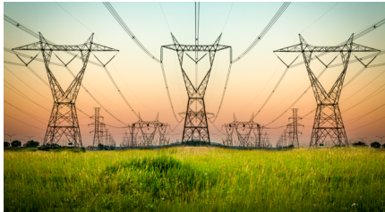
Apoyo a la infraestructura eléctrica regional
